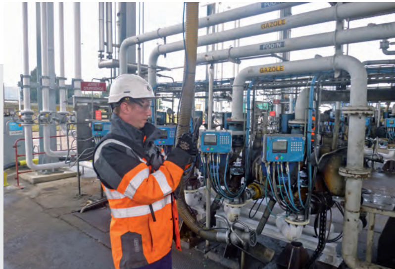
Intervention avec console portable sur un calculateur de dosage et quantité de chargement camion-citerne.
