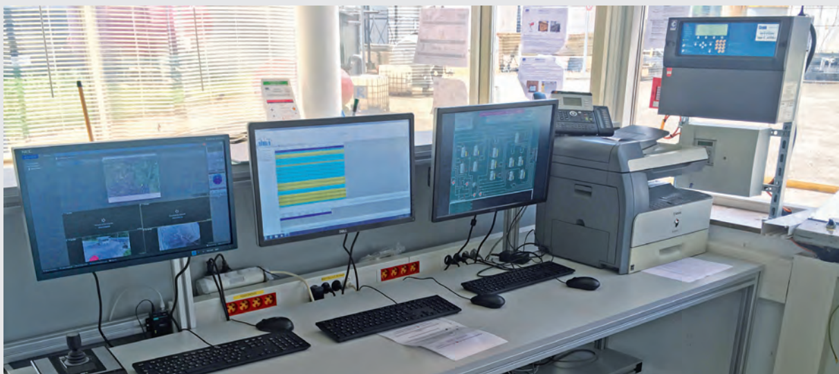
Poste de contrôle.
